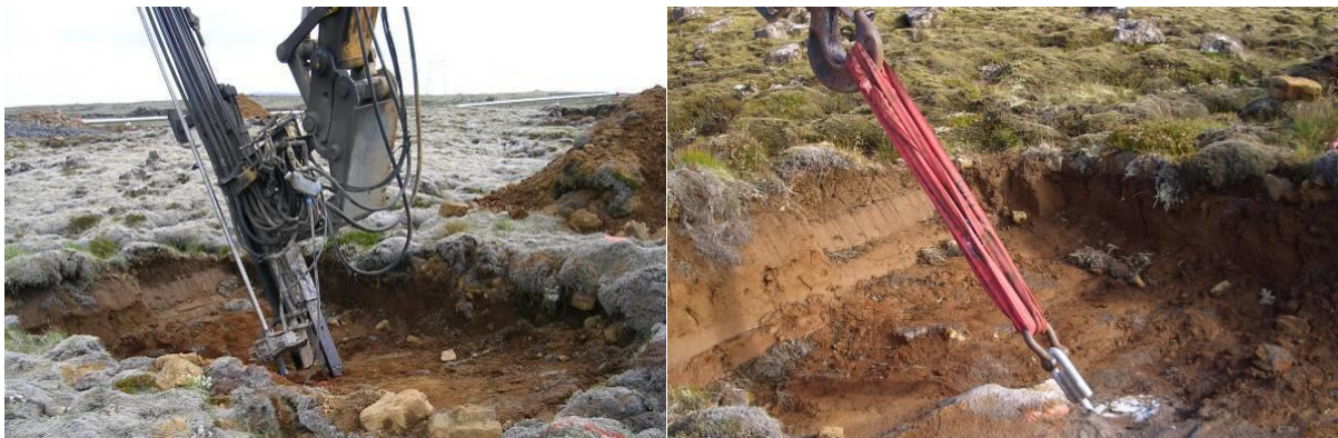
MYND 4.9 Til vinstri sést hvar borað er fyrir bergbolta. Myndin til hægri sýnir bergboltapröfun.
